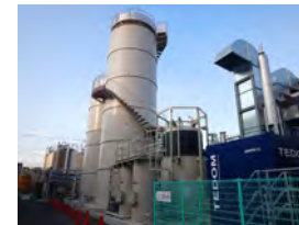
八王子総合工場 バイオマス発電施設
