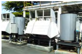
チラー(冷却水循環装置)
