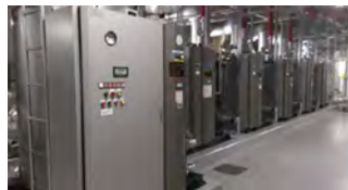
派生油活用ボイラー（ファインケミカル総合工場鹿島油脂工場）
